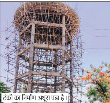
टंकी का निर्माण अधूरा पड़ा है।
